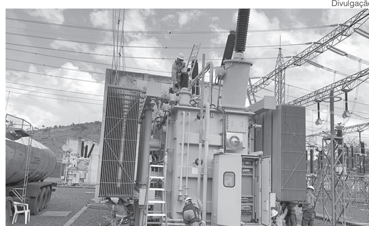
Normalização ocorreu após funcionamento do segundo transformador
